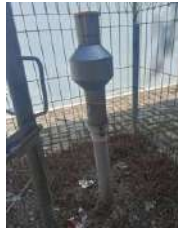
Kondisi ombrometer (baik)
