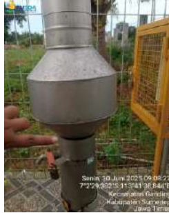
Kondisi keran (baik) Sambungan las (rusak)
