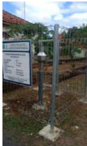
Kondisi keran (rusak)
