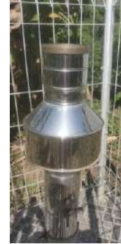
Kondisi corong (baik) Kondisi keran berkarat (sedang)
