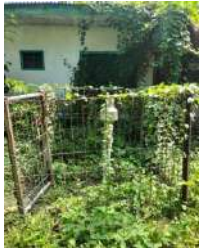
Kondisi pagar (baik) Kondisi gembok (tidak ada ) Kondisi papan nama (tidak ada)
