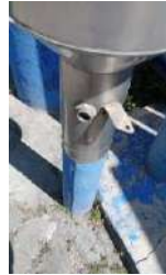
Kondisi keran (tidak ada)
