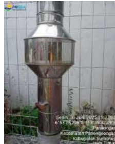
Kondisi keran (rusak)
