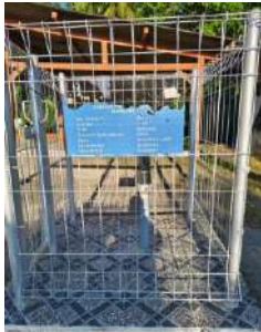
Kondisi papan nama rusak (sedang)
