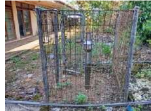
Kondisi pagar (baik) Kondisi papan nama (tidak ada)
