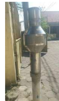
Kondisi keran (rusak)
