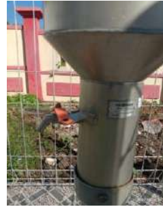
Kondisi keran (baik)
