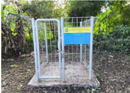
Kondisi papan nama rusak (sedang)
