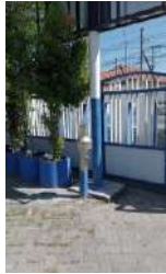
Kondisi pagar, papan nama dan gembok (tidak ada)
