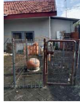
Kondisi pagar berkarat (sedang) Kondisi gembok (tidak ada) Kondisi papan nama (tidak ada)
