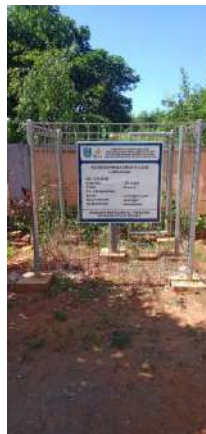
Kondisi papan nama dan pagar (baik) Kondisi gembok (tidak ada)
