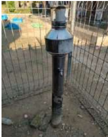
Kondisi alat (tegak) Kondisi corong berkarat (sedang)
