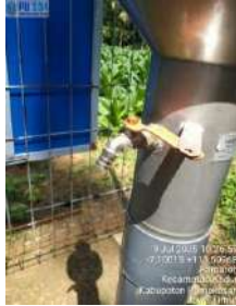
Kondisi keran (baik)
