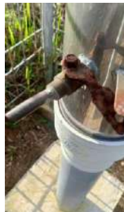
Kondisi keran (rusak)
