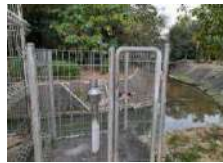
Kondisi papan nama dan gembok (tidak ada) Kondisi pagar (baik)
