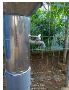
Kondisi keran (baik)
