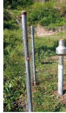
Kondisi pagar sedikit berkarat (sedang) Kondisi gembok (tidak ada)
