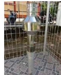
Kondisi ombrometer (baik)
